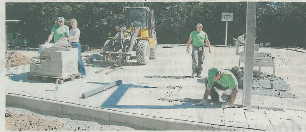
Wunschtraum: Der Bau der Socceranlage am Inselhaus schreitet voran. Links Elke Burghardt im Gespräch mit dem Polier der Firma Holzer, Christian Linke.
